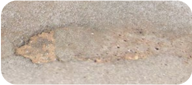
Tratti con presenza di buche
